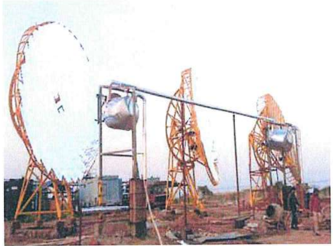
पाइपिंग और इन्सुलेशन के साथ कास्ट आयरन रिसीवर का स्थान
