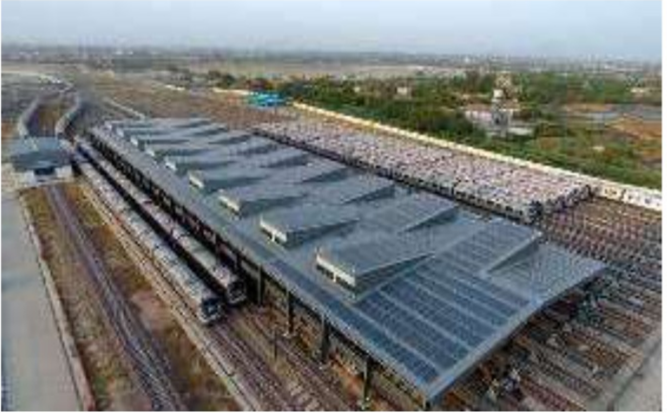
दिल्ली मेट्रो रेल कॉर्पोरेशन लिमिटेड के मुकुंदपुर मेट्रो स्टेशन पर 387 किलोवाट पीक का संस्थापित ग्रिड-संबद्ध सौर रूफटॉप संयंत्र
