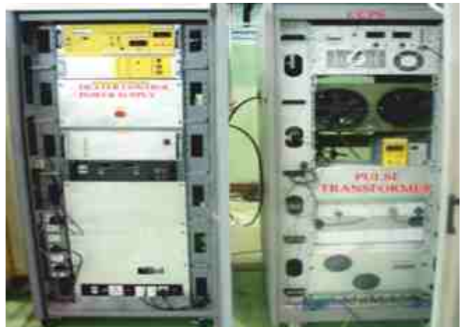
90 kV ठोस अवस्था पल्स माड्युलेटर असेंबली
