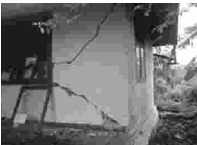
चित्र-23 : वर्ष 2006 में मध्य जावा और 2007 में बेंगकुलु (Bengkulu) में आये भूकम्प के कारण इंडोनेशिया में कॉन्फाइन्ड भवन निर्माण तकनीक से बने भवनों को हुयी क्षति के दृश्य। ( 11 )
