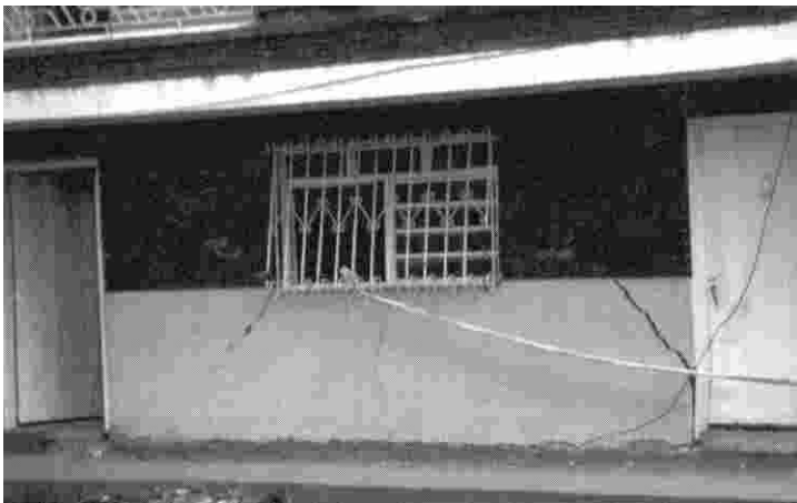
चित्र-21 : 1991 में एल क्विन्डो (El Quindio), कोलंबिया (Colombia) में आये भूकम्प में कॉन्फाइन्ड भवन निर्माण तकनीक से बने भवन के भूतल को हुयी क्षति ( ध्यान से देखें तो स्पष्ट होता है कि खिड़की दरवाजों के आस-पास टाई-कॉलम नहीं बनाये गये हैं )। ( 8 )
